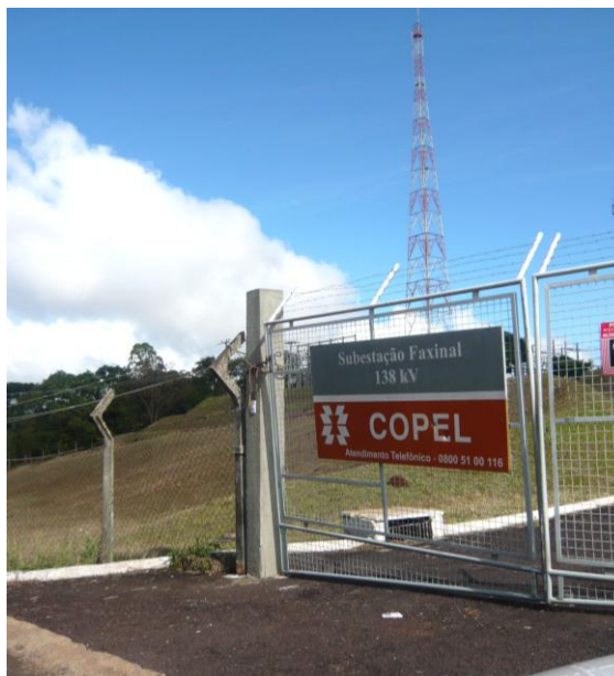
FIGURA 62 – SUBESTAÇÃO DA COPEL EM FAXINAL – 2009
